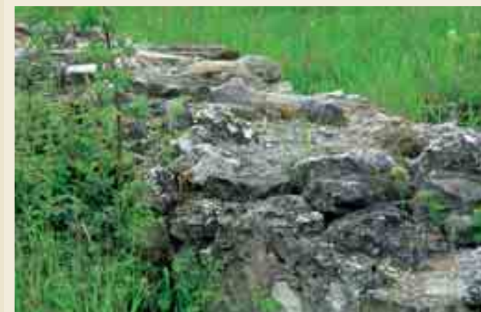
Rímsky vojenský tábor v Iži, narušenie koruny muriva opevnenia, prezentovaného nad úrovňou terénu, prerastaním náletovou zeleňou a machmi. Roman military camp in Iža, fortification walls' coping, presented above the terrain level, damaged by grass and moss.
