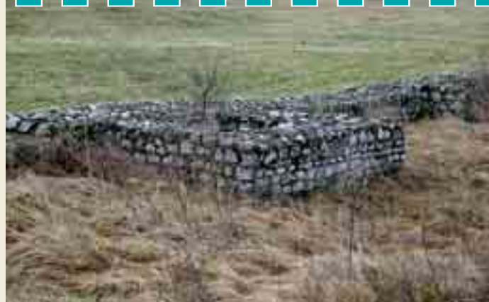
Rímsky vojenský tábor v Iži, náletová krovinová a stromová zeleň, ktorá pokiaľ nie je pravidelne odstraňovaná, poškodzuje murivá prerastaním svojho koreňového systému. Roman military camp (fort) in Iža, wildly grown bushes and trees, which damage the walls with their roots unless they are regularly removed.
