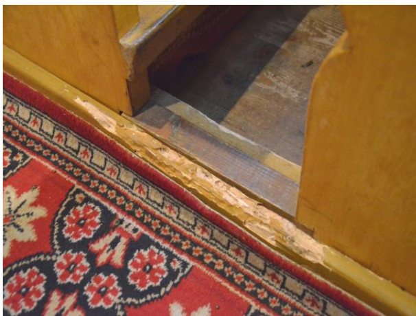
Obr. 8 Lišty lavíc, mechanicky poškodená drevná hmota
