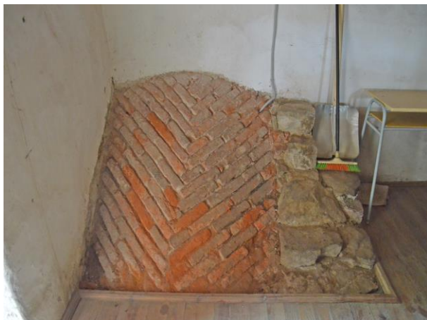
Obr. 43 V juhovýchodnej časti sakristie je možné vidieť zavíhanie a rozpadanie tehiel
