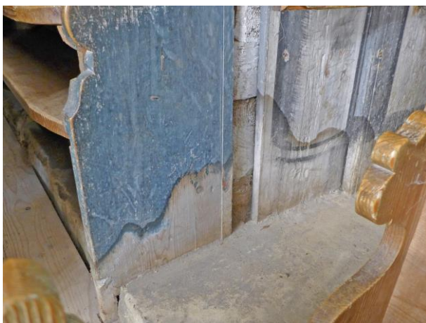
Obr. 62 Aktuálne zavíhanie, vlhkostné fláky siahajúce do výšky 36 cm, južná strana
