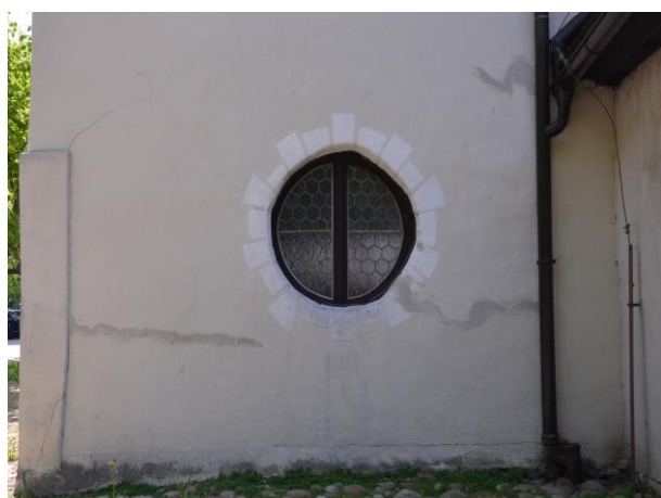
Obr. 37 Šetrne vyplnené trhliny v omietke na južnej stene západného ramena a vznikajúce nové trhliny
