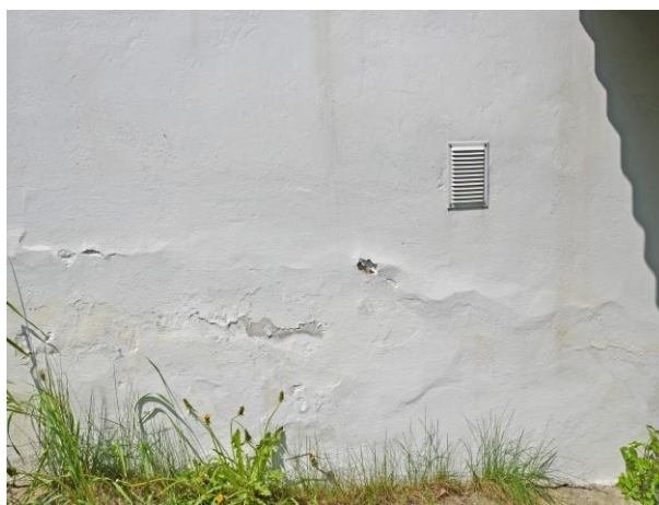
Obr. 59 Popraskaná omietka na západnej strane kostola
