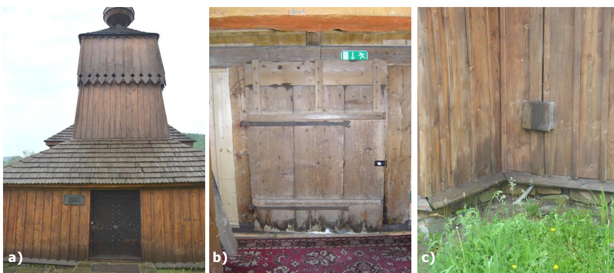
Obr. 7 a) Zavlhnutie vonkajšieho opláštenia dreva na západnej stene chrámu, máj 2017. b) Zatekanie pozorované na poškodených vchodových dverách, máj 2016. c) Zavlhnutý roh južného vonkajšieho opláštenia dreva, máj 2017
