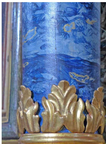
Obr. 35 Uvoľnená farebná vrstva na pravom architektonickom stĺpe
