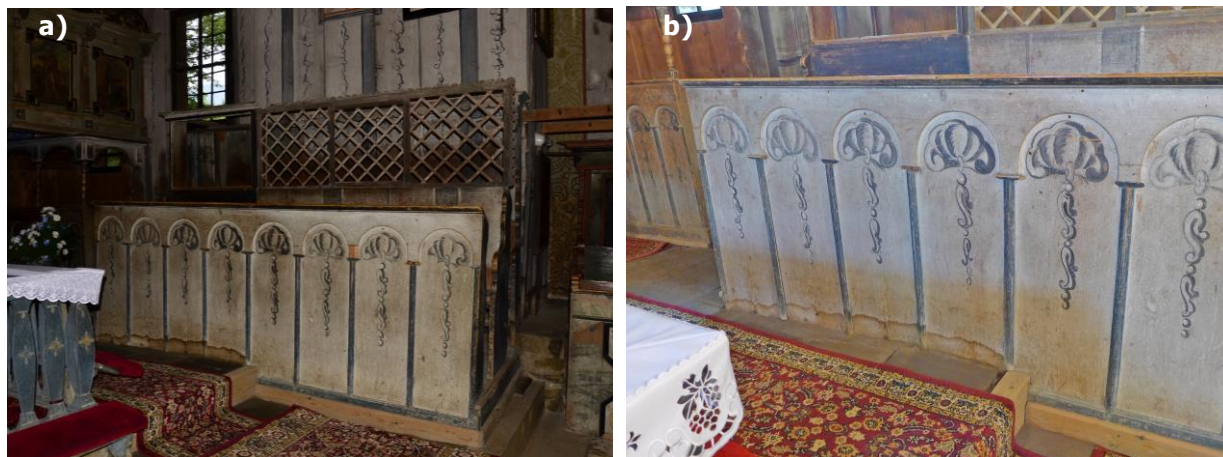
Obr. 65 Zmeskalovská lavica zavíha zospodu južnej strany kostola, poškodená farebná vrstva v porovnaní rokov a) máj 2015 a b) máj 2017
