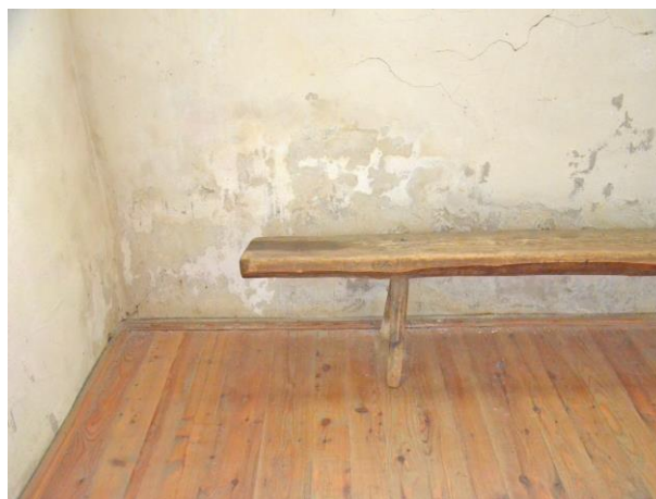
Obr. 42 Opadaná omietka v spodnej časti východnej steny nad podlahou v sakristii
