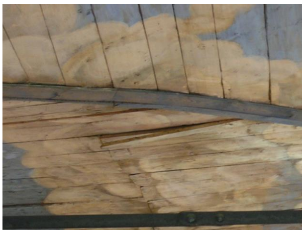
Obr. 39 Prečnievajúca uvoľnená doska z maľovaného obloženia stropu v mieste kríženia klenieb, máj 2016
