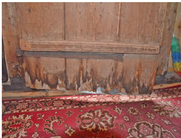
Obr. 10 Interiér – detail zavlhnutých, poškodených vchodových dverí, máj 2017
