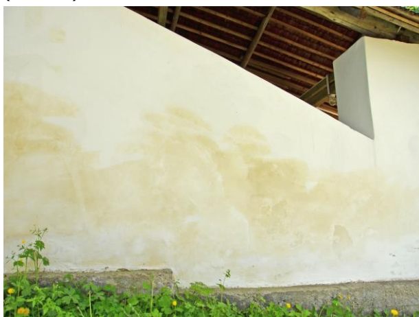
Obr. 58 Vlhkostné fľaky prenikajúce cez nový náter omietky ľavého múra na vonkajšej strane schodiska
