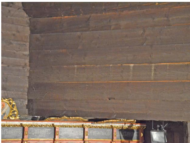
Obr. 49 Drevná hmota južnej steny presbytéria s mechanickým poškodením, výletové otvory s prachovými frakciami
