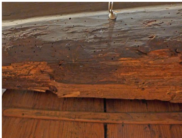
Obr. 50 Degradovaná drevná hmota s výletovými otvormi po drevokaznom hmyze
