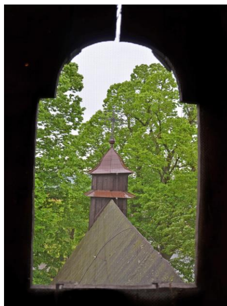
Obr. 18 Šindľová strecha obrastená nižšími rastlinami, pohľad zo zvonice na severnú stranu strechy, máj 2017
