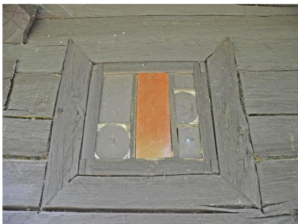
Obr. 68 Poškodenie pôvodnej výplne okna. Nad hornou časťou okna sú viditeľné výletové otvory (biele bodky)
