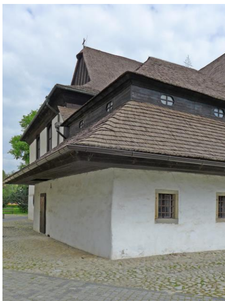
Obr. 41 Zavlhnutá architektúra kostola, juhovýchodná strana
