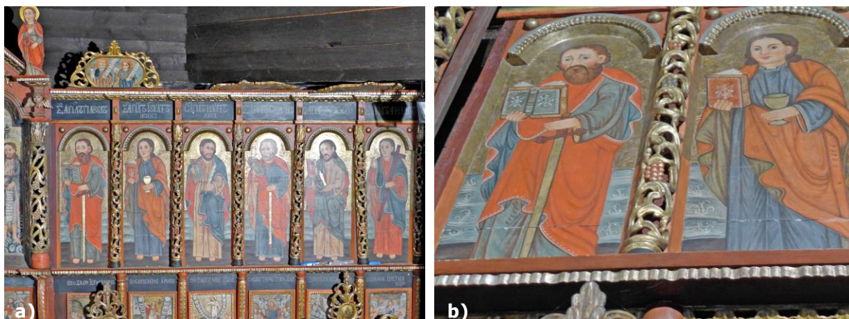
Obr. 53 Ikonostas – pravý rad apoštolov: a) poškodenie, prasknutie ikon v spodnej časti, b) detail poškodenia
