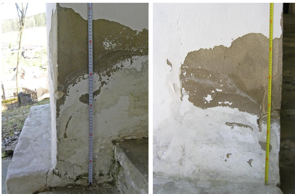
Obr. 6.2-3. Vlhkostné fláky a opadaná omietka ľavého múra schodiska (až do výšky 60 cm), porovnanie stavu z roku 2014. K výrazným zmenám nedošlo.
