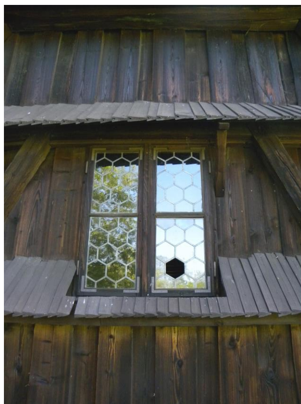
Obr. 3.4. Chýbajúci šesťuholník okennej výplne okna na východnej strane objektu.
