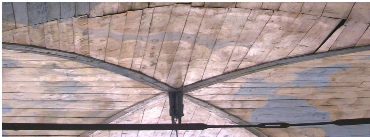
Obr. 4.4. Prečnievajúca uvoľnená doska z maľovaného obloženia stropu v mieste kríženia klenieb
