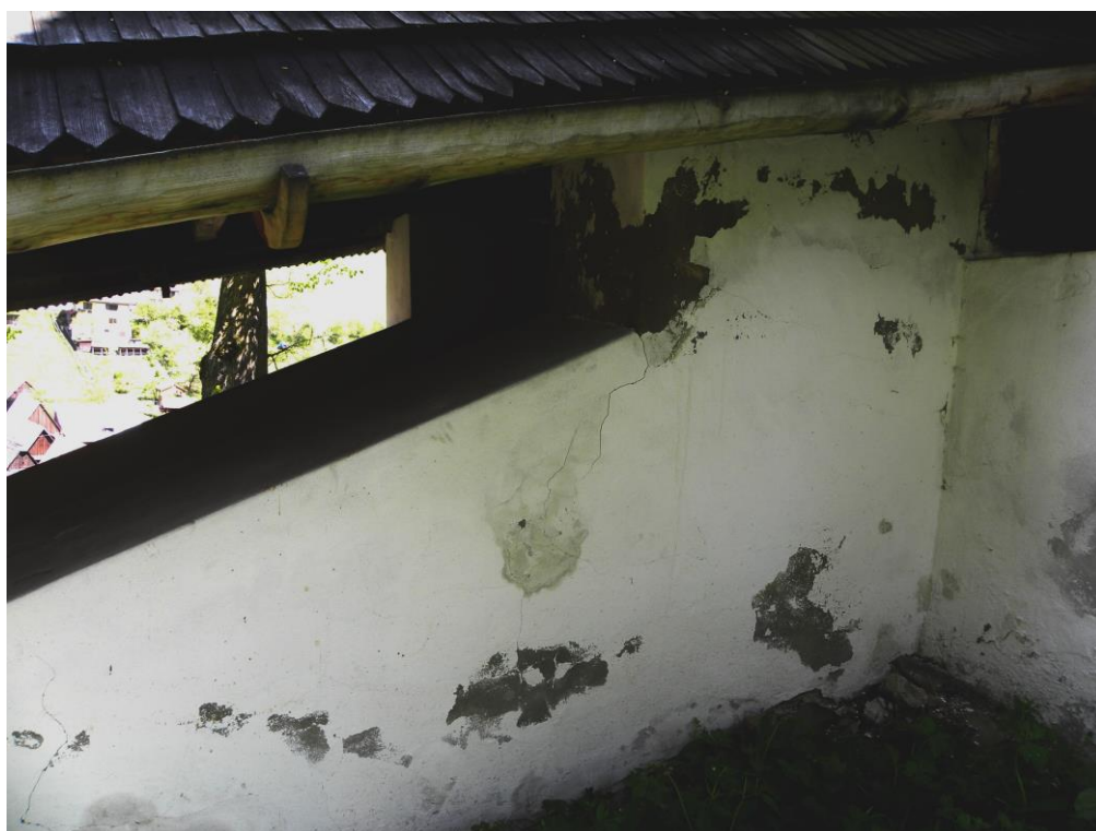
Obr. 6.4. Opadaná a popraskaná omietka na južnej strane kostola.
