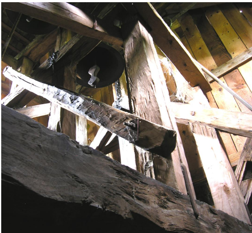
Obr. 7.6. poškodenie niektorých trávov vo veži
