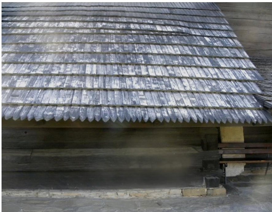
Obr. 8.2. Vyblednutá strešná krytina na južnej strane objektu.
