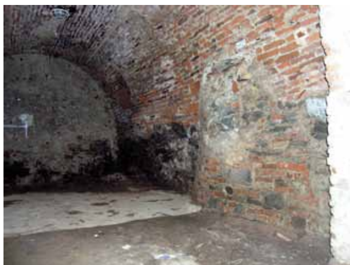
Druhotne vložený útvar (v pôdoryse polelipsa) s primárne osadenou pravouhlou nikou pre vstavanú skrinku (zachoval sa odhnutý drevený preklad a kovový pánt dvierok skrinky) na južnej stene p. č. 1.09 dvorového krídla
