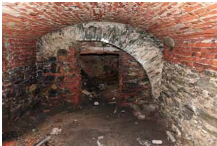
Pohľad na severnú stenu pivnice dvorového krídla so stredovekým murivom a kamennými konzolami
