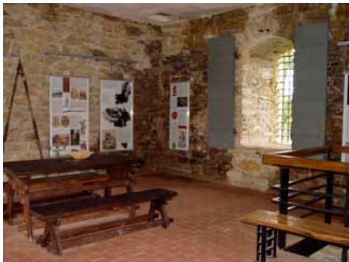
Interiér expozície Huňadyho veže poškodený zatečením vodou z korún murív a plochej strechy za atikou (foto: M. Janovská)
