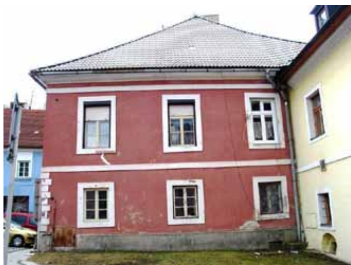
Západná uličná fasáda pred výmenou okenných výplní a dvernej výplne. V pravom dolnom rohu sú vetráky suterénov skúmanej časti domu a susedného domu č. 1 na Dolnej ulici.
