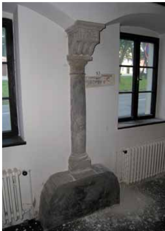
Stĺpik v m. č. 1.02 podložený betónovým soklom s iniciálami (M. T.) a vročením na čelnej strane konzoly (1697)
