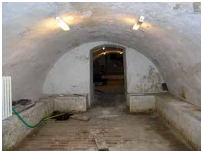
Suterénne priestory s nevhodnou novodobou úpravou – priebežným betónovým soklom a nepriedušnou cementovou omietkou (pohľad z p. č. 0.02 do 0.01)
