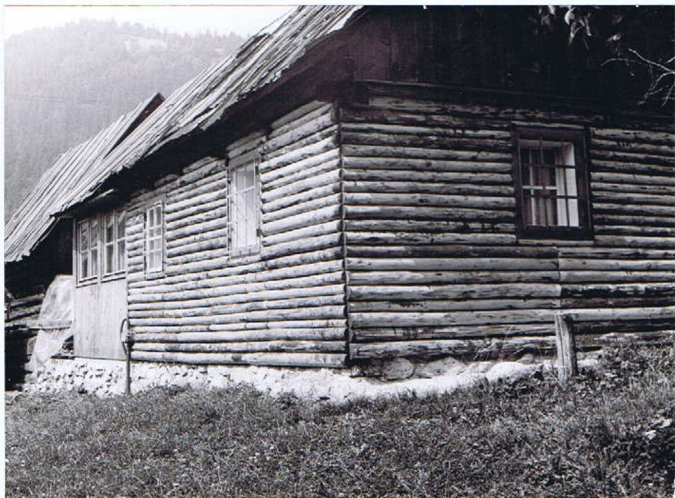
45. objekt č. 46 - nevhodná úprava stien a okien
