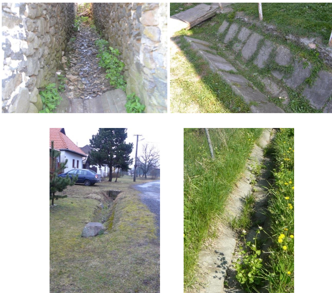
Systém odvodu dažďových vôd (rigoly, jarky)
