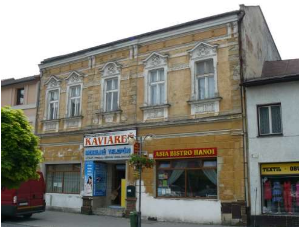
Nám. Slovenskej republiky, súpisné číslo 27, parcelné číslo KN 7/1 - predmetom ochrany je: H – hmota uličného krídla, F – fasáda so štukovou výzdobou, U – štuková výzdoba fasády, S – tvar, parter je možné upraviť v súlade s hodnotami objektu
