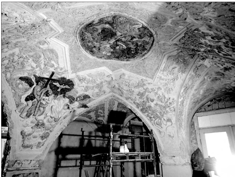
Obr. 14. Klenba miestnosti v meštianskom dome na Štefánikovej ulici č. 37 v Trnave, stav po odstránení mladších náterov, foto: J. Žuffová.
