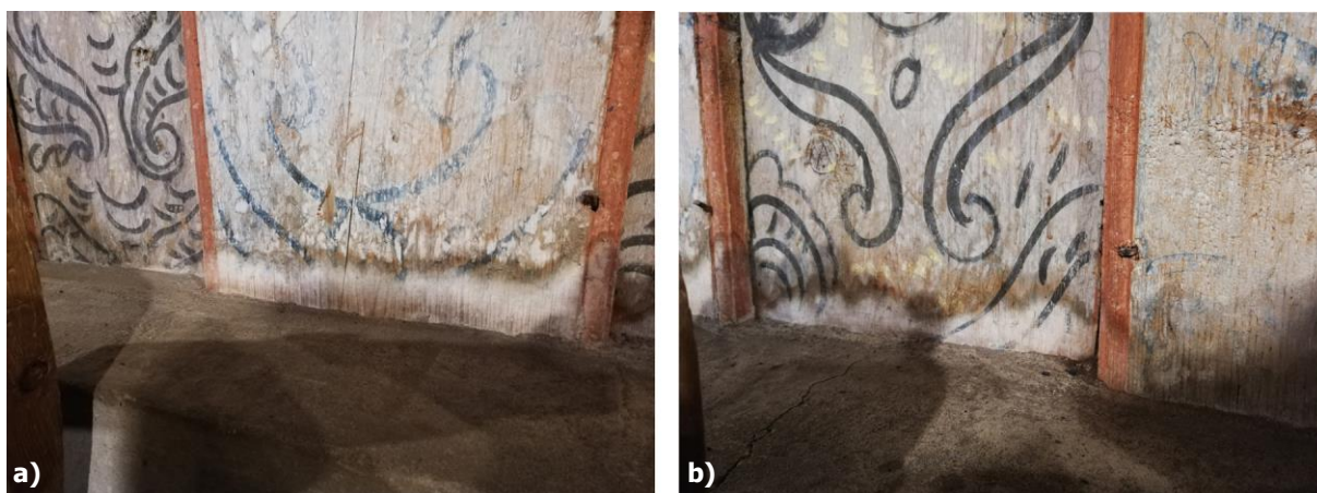
Obr. 66 a) – b) Poškodenie farebnej výzdoby navlhnutím od muriva, foto: R. Tóth.
