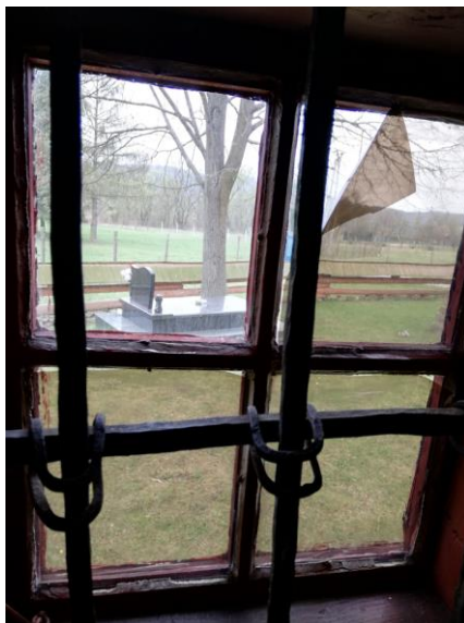
Obr. 49 Ochranná UV fólia odlepujúca sa od sklenenej výplne okna, foto:R. Tóth;
