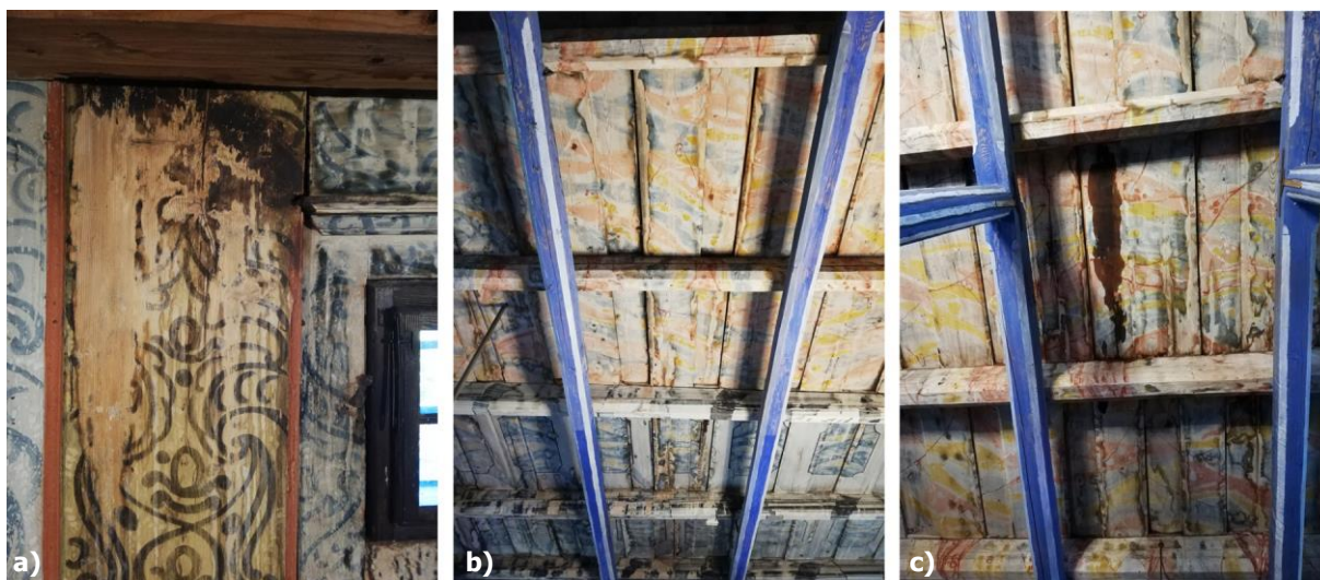
Obr. 65 Poškodenie farebnej výzdoby a) na drevenom obložení stien b) – c) na obložení stropu, foto: R. Tóth.
