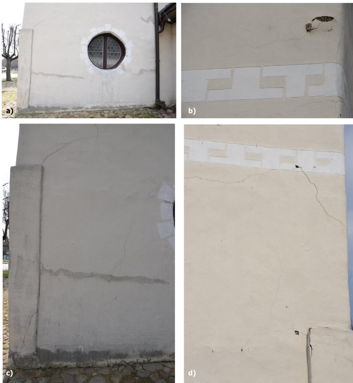
Obr. 38 a) Omietka s vyplnenými prasklinami; b) opadnutý biely náter; c) detail na vyplnenú prasklinu; d) prasklina s dierou po vypadnutom kuse omietky, foto: L. Dubinyová.
