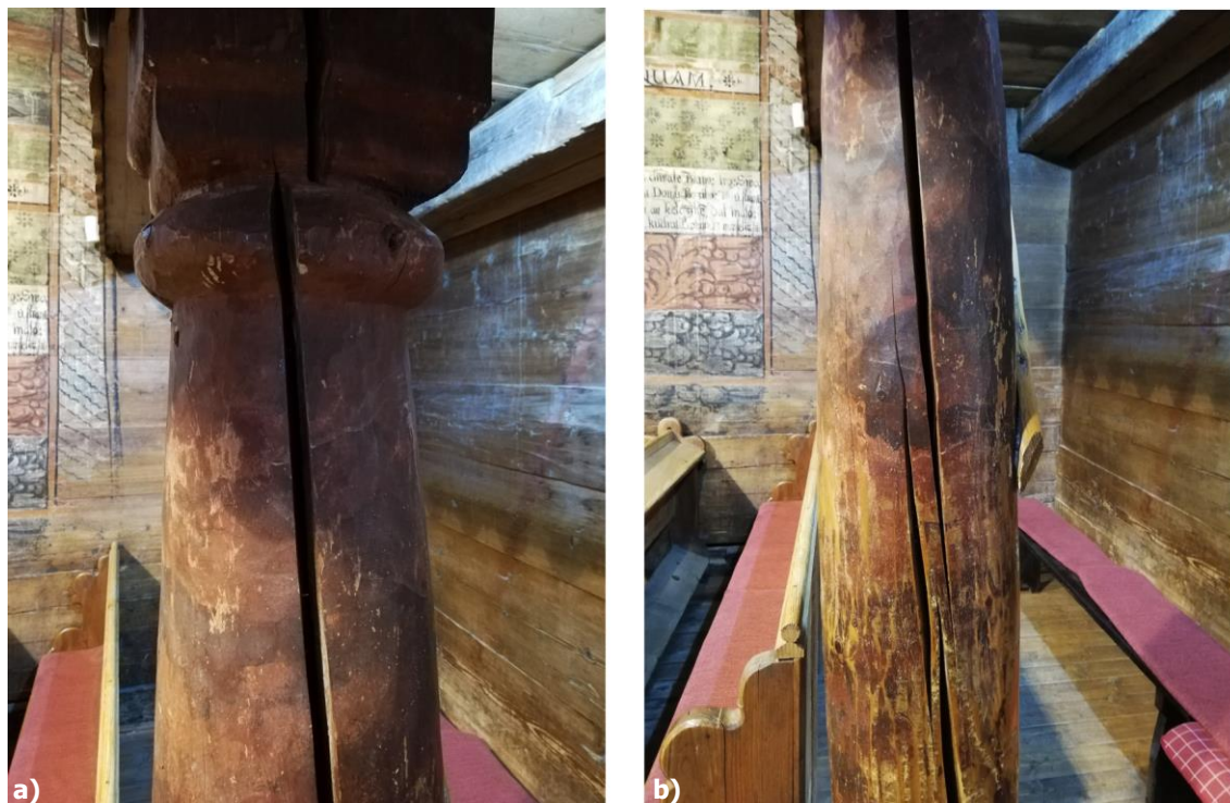
Obr. 15 Prasknutý drevený nosný stĺp pod emporou a) hlavica b) driek, foto: R. Tóth.
