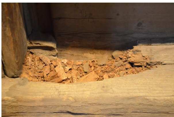
Obr. 40 Poškodenie trámu severnej empory, foto: L. Dubinyová.
