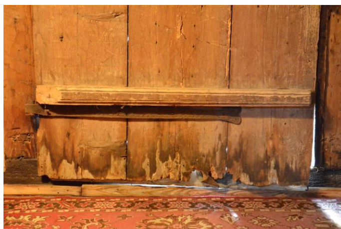
Obr. 7 Detail zavlhnutých, poškodených vchodových dverí z interiérovej strany, foto: L. Dubinyová.
