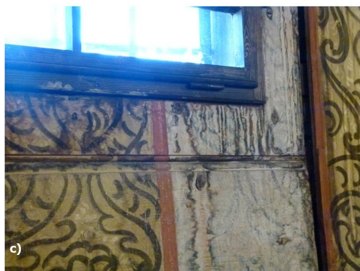
Obr. 67 a) – c) Poškodenie farebnej výzdoby zatečením, foto: R. Tóth.
