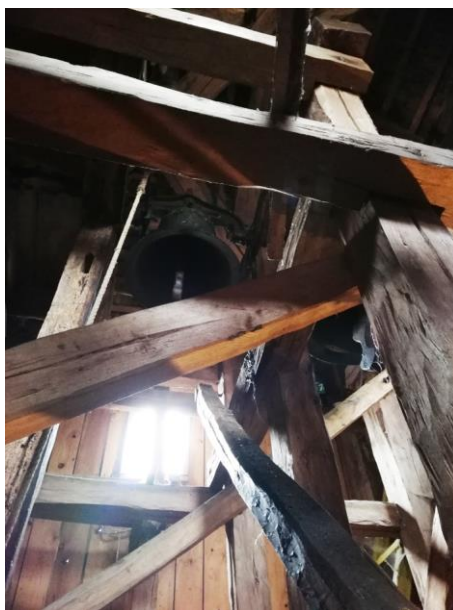
Obr. 86 Poškodenie trámov vo veži sa stále zhoršuje, foto: R. Tóth.
