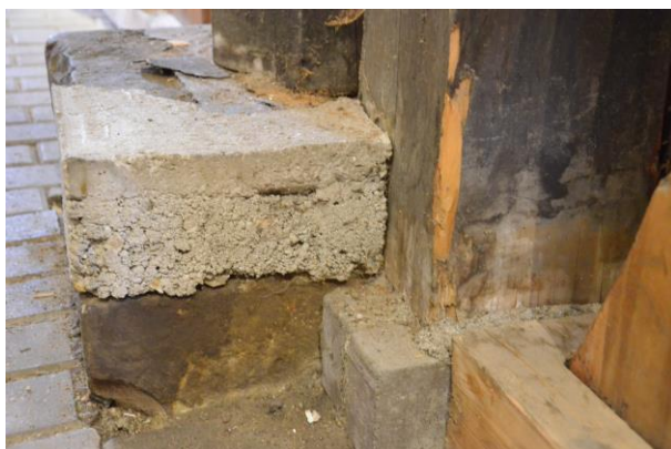
Obr. 41 Poškodená a betónom opravená päťka stĺpu S3, foto: L. Dubinyová.
