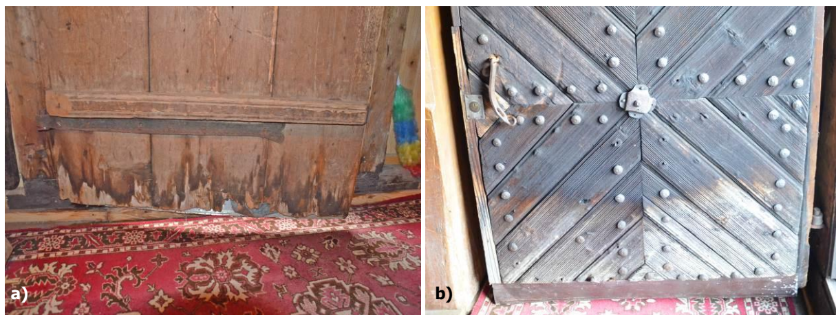
Obr. 7 Detail zavlhnutých, poškodených vchodových dverí; a) dvere z interiérovej strany, b) dvere z exteriérovej strany, foto: L. Dubinyová.
