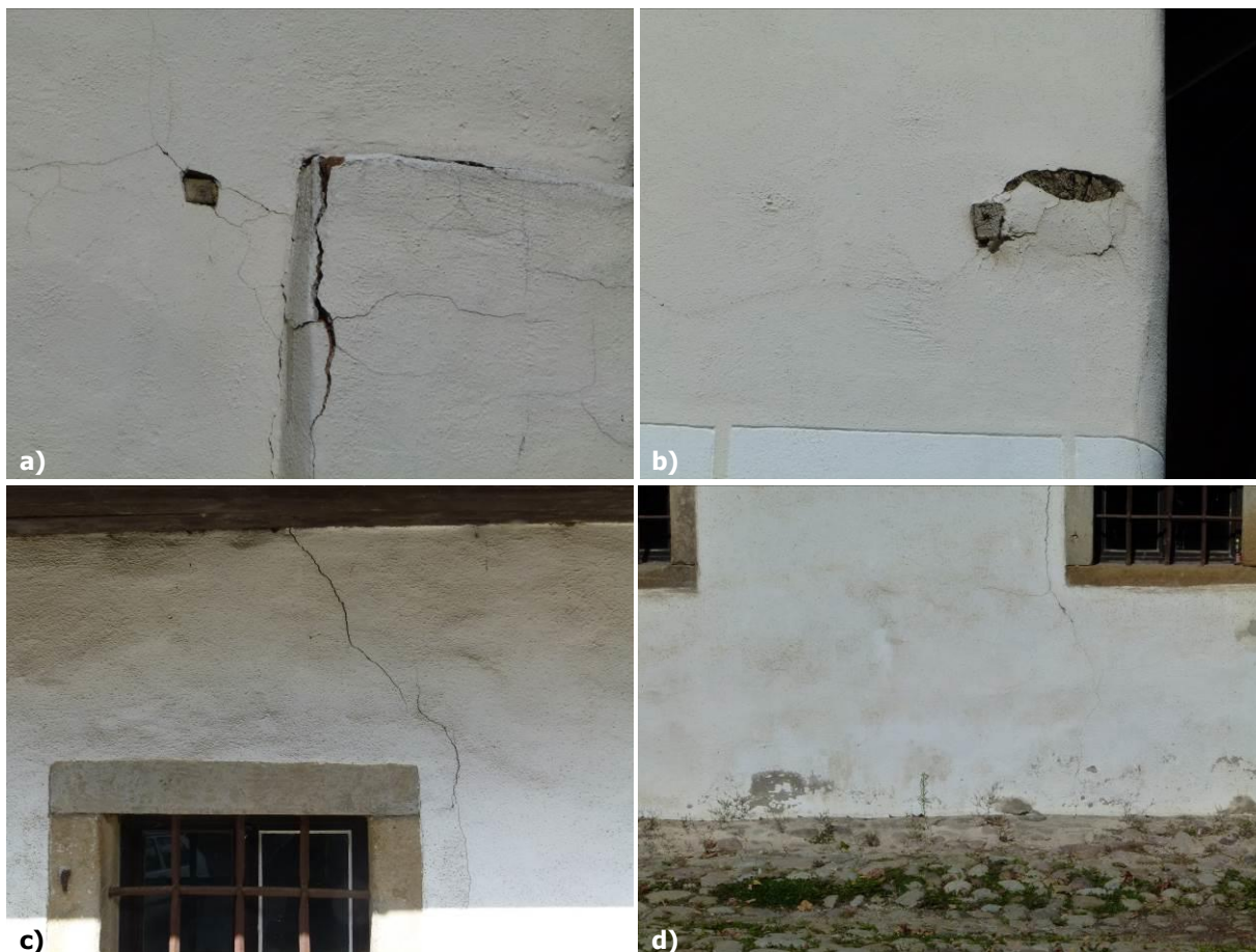
Obr. 34 a – c) Omiетка s ojedinelým výskytom prasklín a trhlín; d) lokálne sa vyskytujúci opadaný biely náter, foto: R. Tóth.
