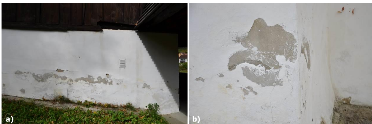
Obr. 57 Opadaná omietka a) na východnej strane kostola; b) na severnej strane kostola, foto: L. Dubinyová.
