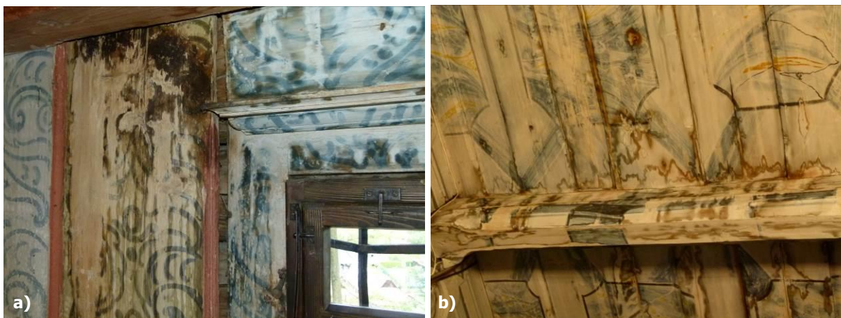
Obr. 67 Poškodenie farebnej výzdoby zatečením a) na drevenom obložení; b) na drevnom tráme a stropnom doskovom obložení, foto: R. Tóth.
