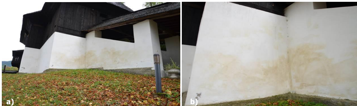
Obr. 55 a – b) Vlhkostné fľaky prenikajúce cez náter omietky ľavého múra (pohľad zo severozápadnej strany) a na vonkajšej strane schodiska, foto: L. Dubinyová.
