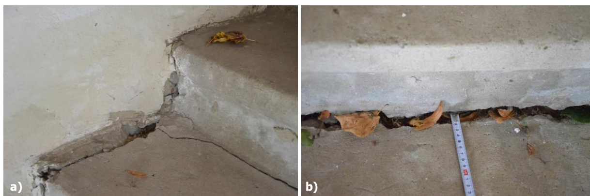
Obr. 60 Vstupné schodisko do kostola a) makro trhliny medzi schodiskovým ramenom a bočnou stenou a medzi schodiskovými stupňami; b) detail makro trhliny medzi schodiskovými stupňami, foto: L. Dubinyová.
