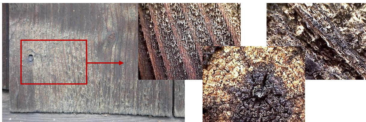
Obr. 65 Povrchové poškodenie dreveného obloženia v exteriéri a mikroskopické detaily, foto: L. Dubinyová.
