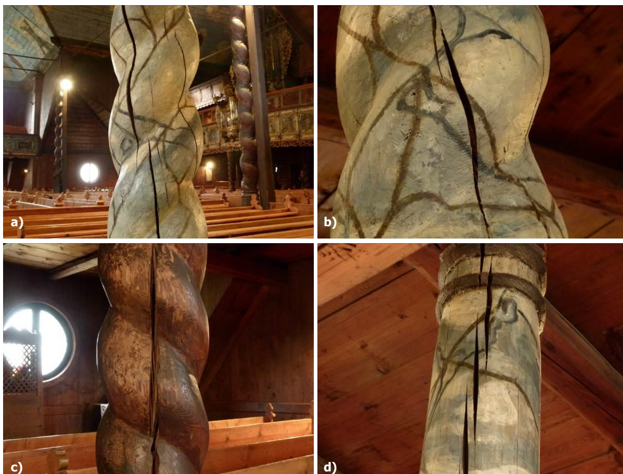
Obr. 41 a – d) Tordované nosné stĺpy pod chórmí s vertikálnymi prasklinami po celom svojom obvode, foto: R. Tóth.
