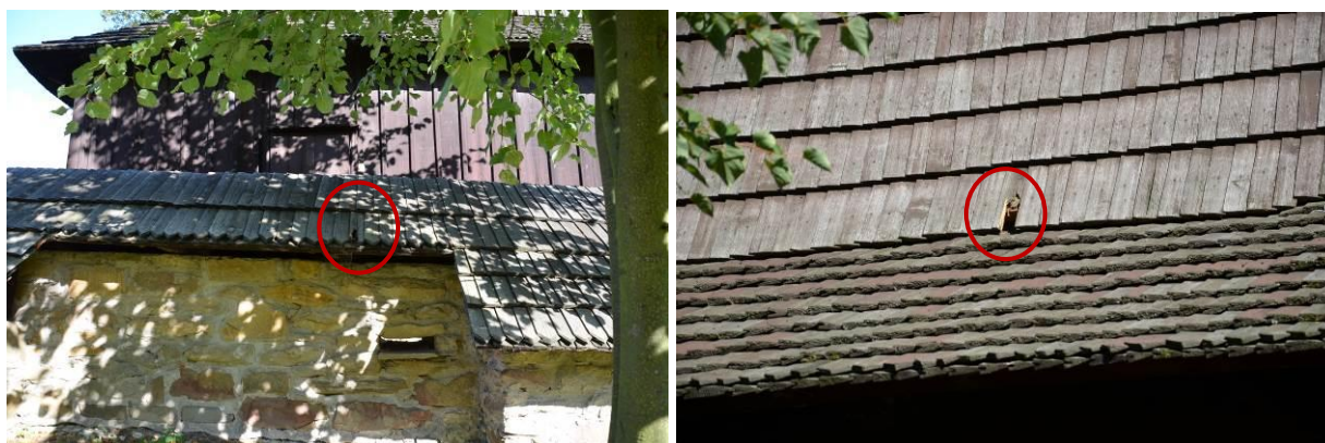
Obr. 14 Drevené šindľe s ojedinele popraskaným a čiastočne vypadaným drevom a) drevené šindľe na kamennom múre; b) strešné drevené šindľe, foto: L. Dubinyová.
