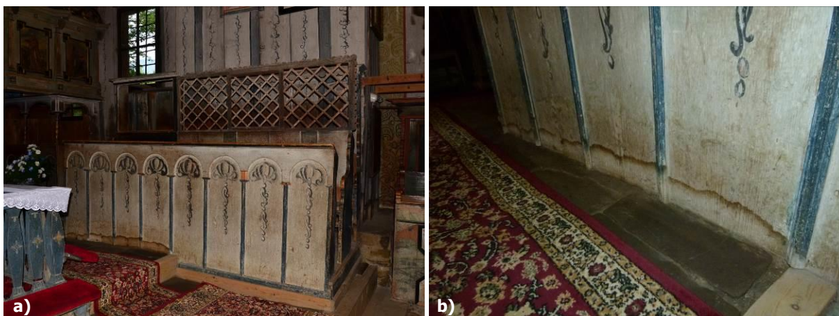
Obr. 66 Zmeškalovská lavica zavlha zospodu južnej strany kostola, poškodená farebná vrstva v porovnaní rokov a) máj 2015, foto: E. Rudinská a b) september 2018, foto: R. Tóth.
