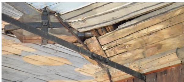
Obr. 36 Poškodenie pravého rohu severnej empory – v časti uchytenia tiahla na drevenom tráme, foto: L. Dubinyová.
