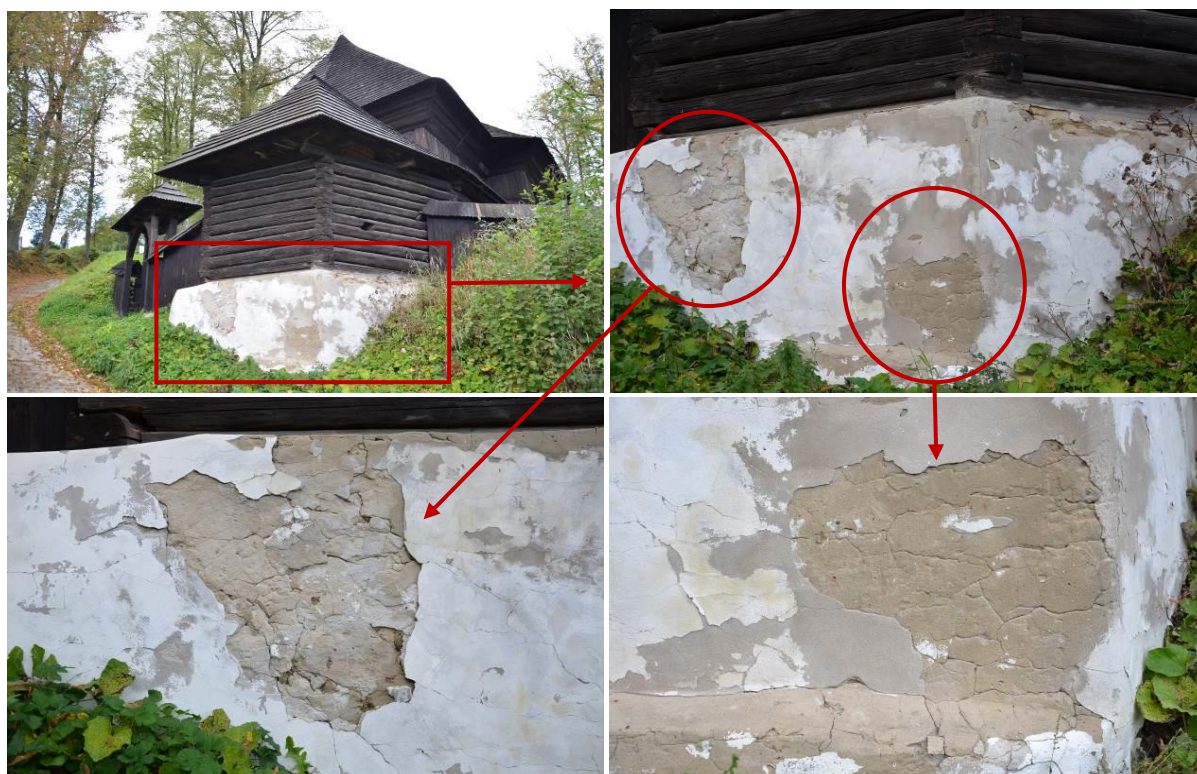
Obr. 58 Opadaná a popraskaná omietka, pohľad na kamenné murivo z východnej strany, ktoré je súčasťou oplatenia kostola, foto: L. Dubinyová.
