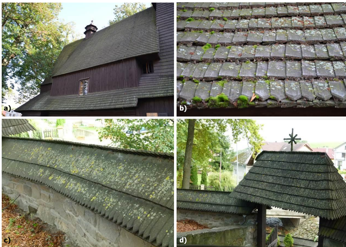
Obr. 13 a – b) Šindľová strecha obrastená nižšími rastlinami, severná strana kostola, foto: L. Dubinyová; c) – d) drevené šindľe na kamennom múre a vstupnej bránke obrastené nižšími rastlinami, foto: R. Tóth.
