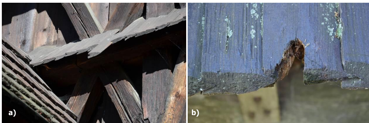
Obr. 28 Drevené strešné šindle a) ojedinele uvoľnené; b) ojedinele popraskané s čiastočne vypadnutým drevom, foto: L. Dubinyová.
