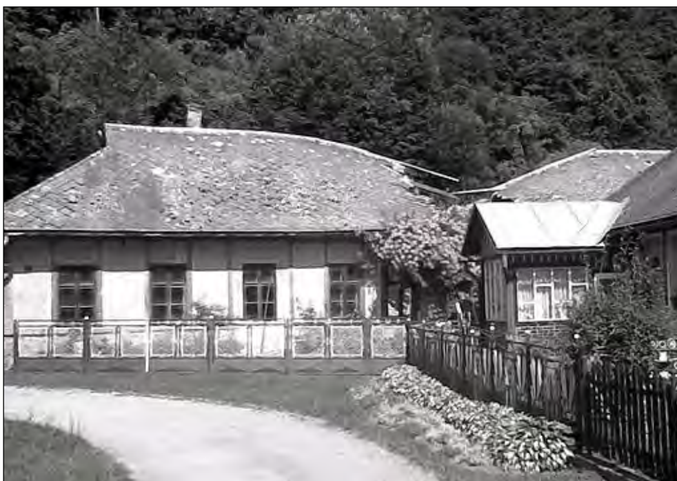
Budova (vzadu), západná fasáda –strecha uprostred preborená, stav v r. 2008, Šulcová 2011
