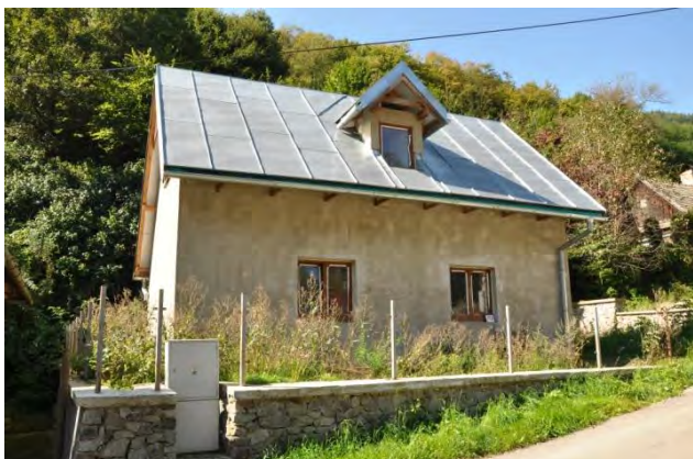
Vysoká strešná nadmurovka, nevhodný tvar vikiera
