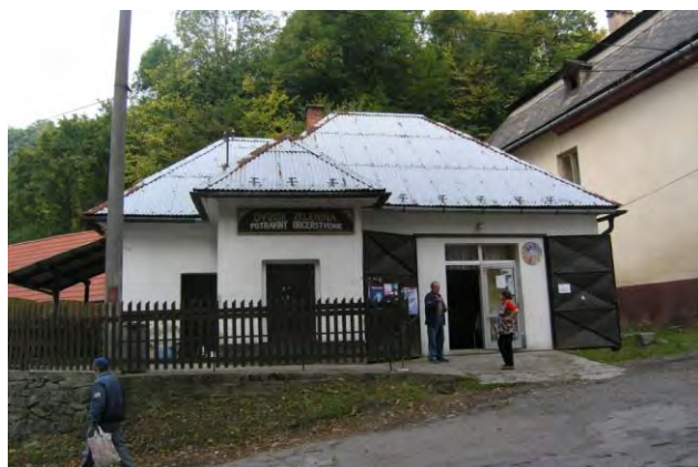
Nevhodná úprava fasád
