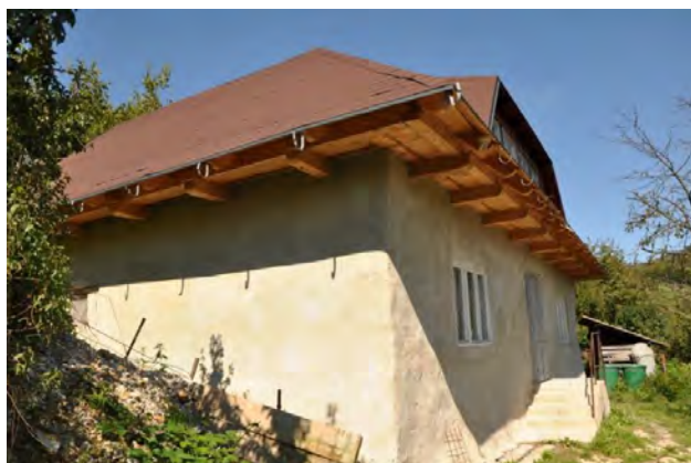
Nevhodný tvar strechy, široké vyloženie
