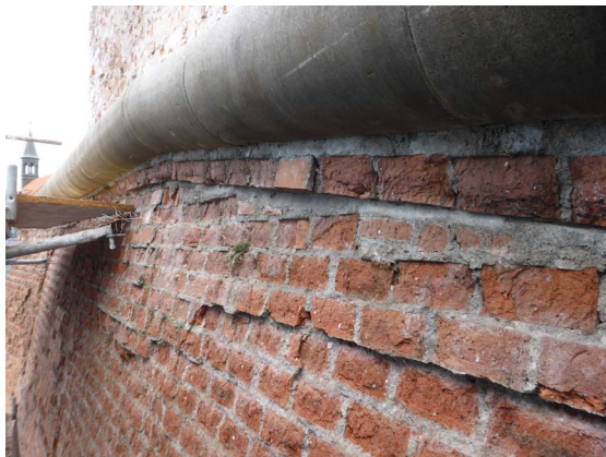
► Obr. 24. Degradácia spekaných tehál škárovaných cementovou maltou; Praha, Pohorelec.
