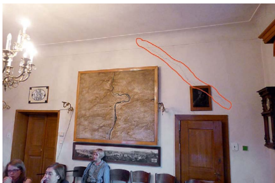
► Obr. 64. Šikmou trhlinou sa prejavuje diagonála v hrazdenej priečke; Juditina veža Karlovoho mosta, Praha.
