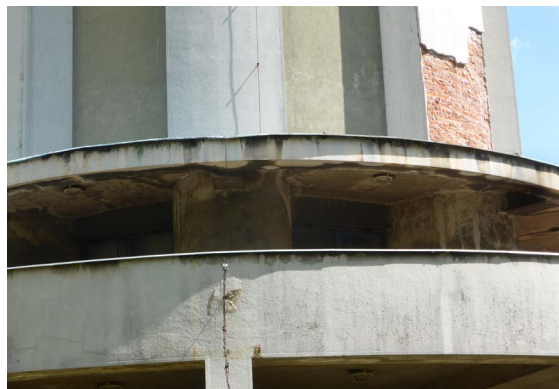
► Obr. 3 a, b. Starnutie tzv. ušľachtilých (cementových) omietok; vodojem Poděbrady; palác Lucerna, 20. storočie.
