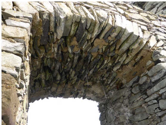
► Obr. 39. Klenba starostlivo vymurovaná z lomového kameňa si zachovala únosnosť aj napriek tomu, že malta zo škár je takmer úplne vyplavená – pozri ladové cencie; hrad Tolštejn.
