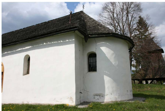
► Obr. 56 a, b. Trhliny vzniknuté v dôsledku sadania základov na ilovitej pôde po realizovaní drenáže pri päte stavby; Trstené, kostol Všetkých svätých.
