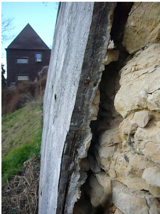
►► Obr. 20. Monolitická koruna bez dilatčných škár, zmršťovacími trhlinami zateká do muriva – nástreč steny cementovou maltou je odtrhnutý; Jihlava.
