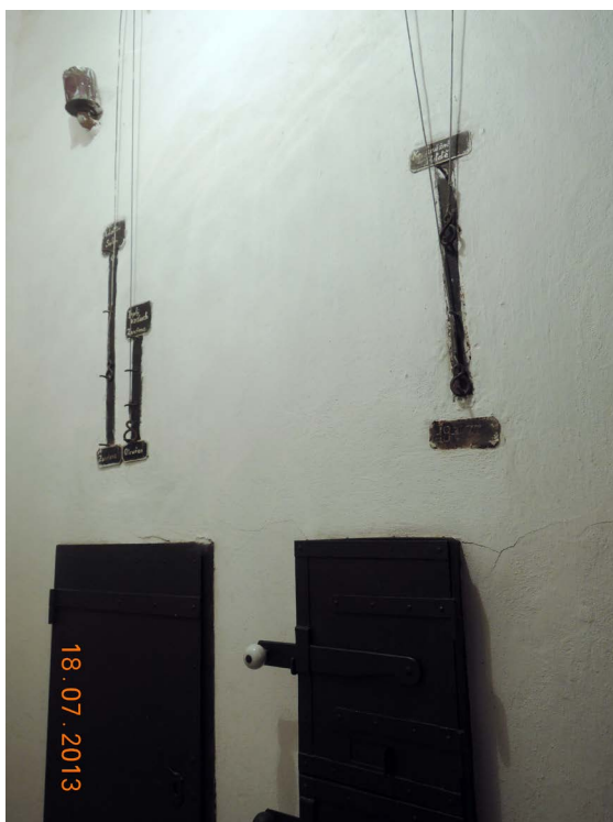
► Obr. 42. Luftheizung, regulácia rozvodov do miestností na zámku v Hlubokej.
