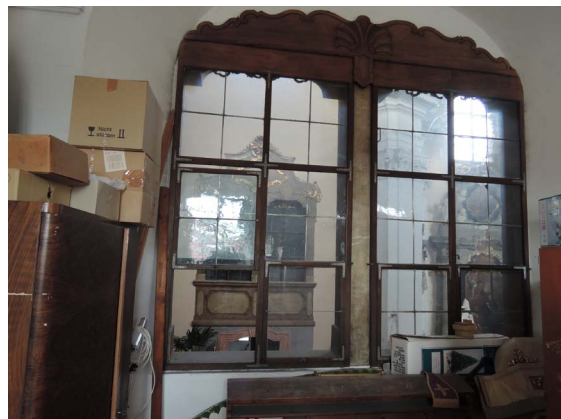
► Obr. 25. Výsuvné okno v oratóriu v Kostole nanebovzatia Panny Márie v Strážnici.
