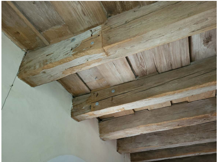
► Obr. 30. Lokálna výmena (protézovanie) odhnitých zhlaví dreveného trámového stropu, sýpka, Svätý Anton.
