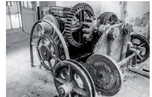
13. Zariadenie na ovládanie pohybu stavidla, zn. VAN BERKEL'S PATENT, Rotterdam, Holland, stav z roku 2017
