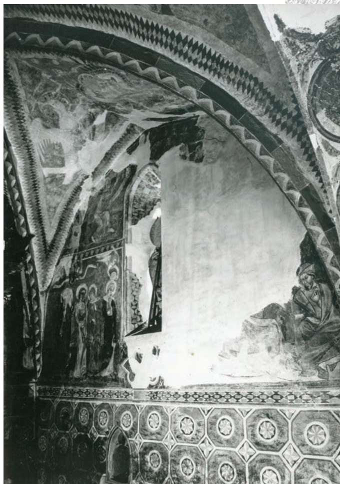
30. Čerín (okr. Banská Bystrica), r. k. Kostol sv. Martina, južná stena presbytéria. Fragmenty nástennej maľby po ostreľovaní, stav po doplnení chýbajúceho muriva (1947). Foto: G. Podhorský, Archív PÚ SR.
