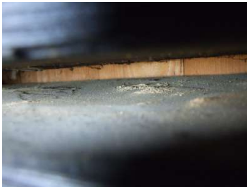
Obr. 8.2. Požerky po drevokaznom hmyze medzi trámami zrubu z vonkajšej strany dokazujú prítomnosť aktívneho hmyzu
