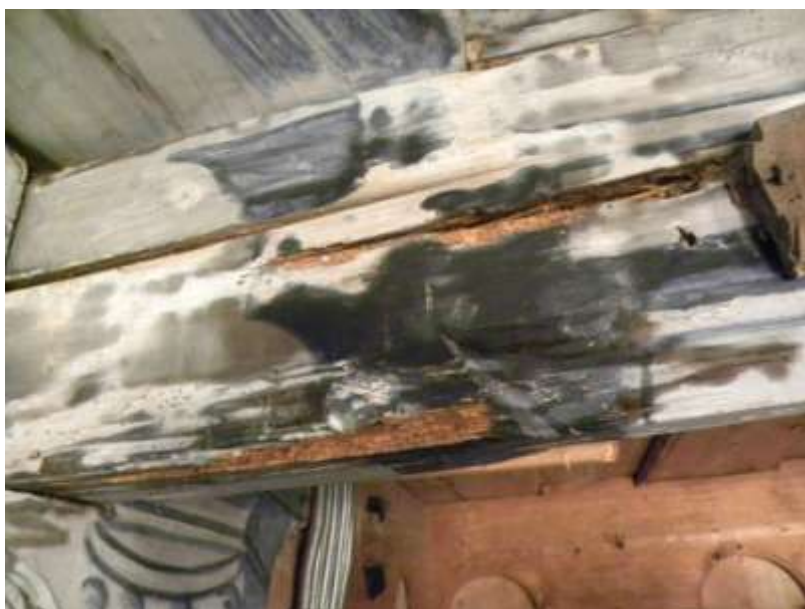
Obr. 6.3. Poškodenie stropného trámu nad východnou emporou so stopami po zatekaní
