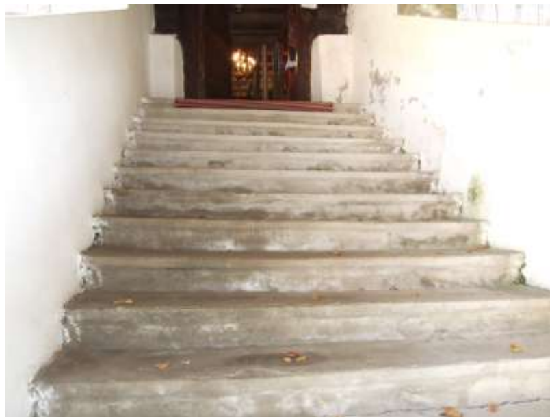
Obr. 6.1. Schodisko k hlavnému vstupu, viditeľné sú vlhkostné fláky, solné výkvety a praskliny
