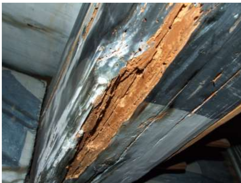
Obr. 6.4. Detail biologického poškodenia drevnej hmoty nosného trámu nad vých. emporou
