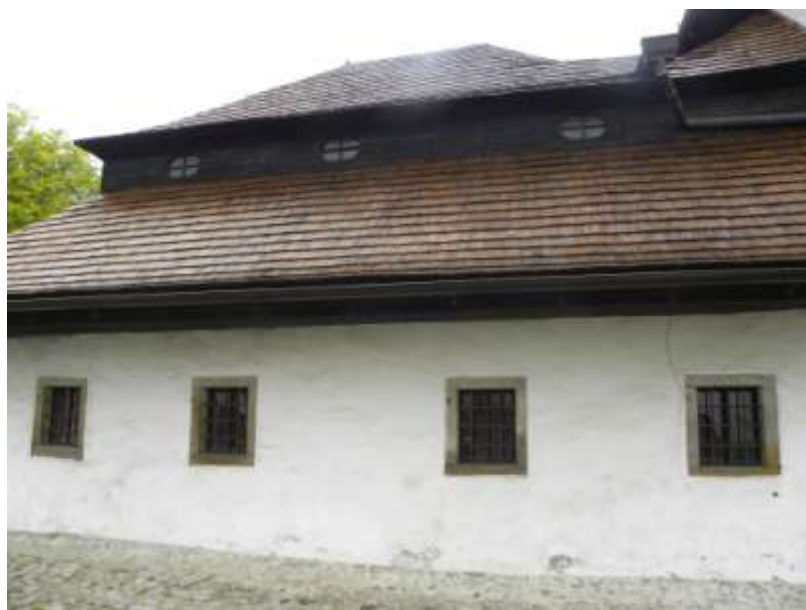
Obr. 4.2. Lokálne dochádza k opadnutiam bieleho náteru z omietky, v blízkosti nad úrovňou dlažby
