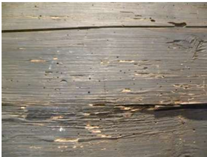
Obr. 5.2. Biodegradácia drevnej hmoty zrubu v presbytériu
