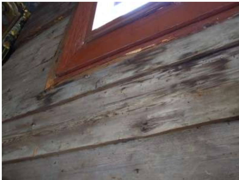
Obr. 1.2. Južná stena lode, pod oknom, nové výletové otvory po drevokaznom hmyze oproti prieskumu v r. 2011 neboli zistené.
