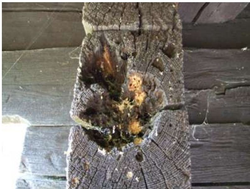
Obr. 7.3. Biodegradácia trámu v zrubovom spoji na južnej strane objektu
