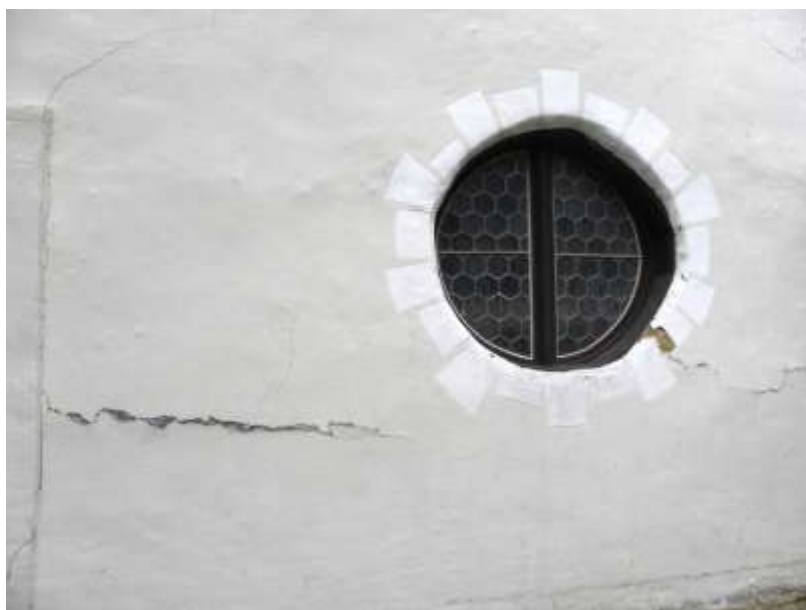
Obr. 4.1. Trhliny v omietke na západnej stene severného ramena, výraznejším zmenám oproti r. 2011 nedošlo
