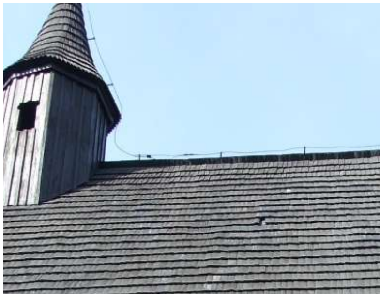
Obr. 8.3. Chýbajúci šindel na južnej strane strechy nad loďou
