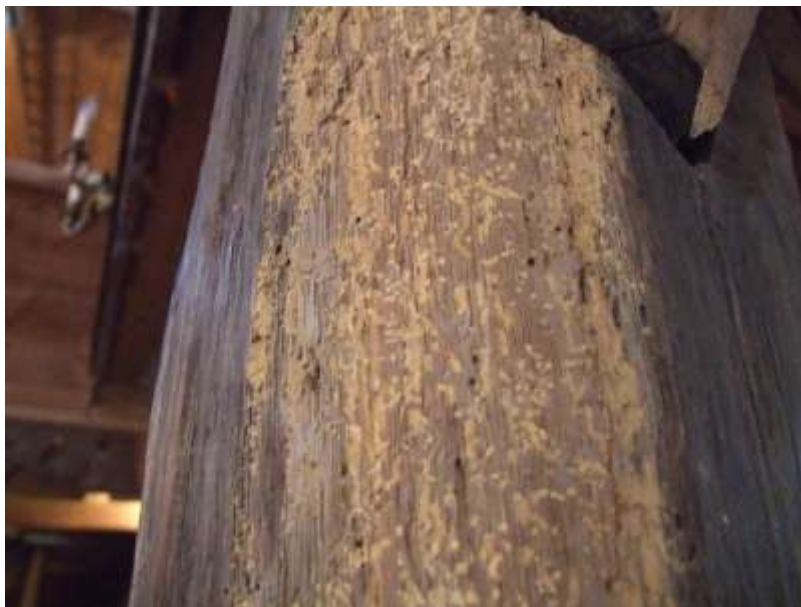
Obr. 3.1. Detail biologického poškodenia nosného stĺpu pod západnou emporou.
