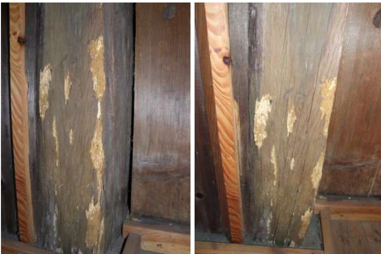
Obr. 3.2-3. Degradovaný stĺp na juhovýchodnom rohu, porovnanie so stavom zo septembra 2011 (obr. 3.2), k výrazným zmenám nedošlo.
