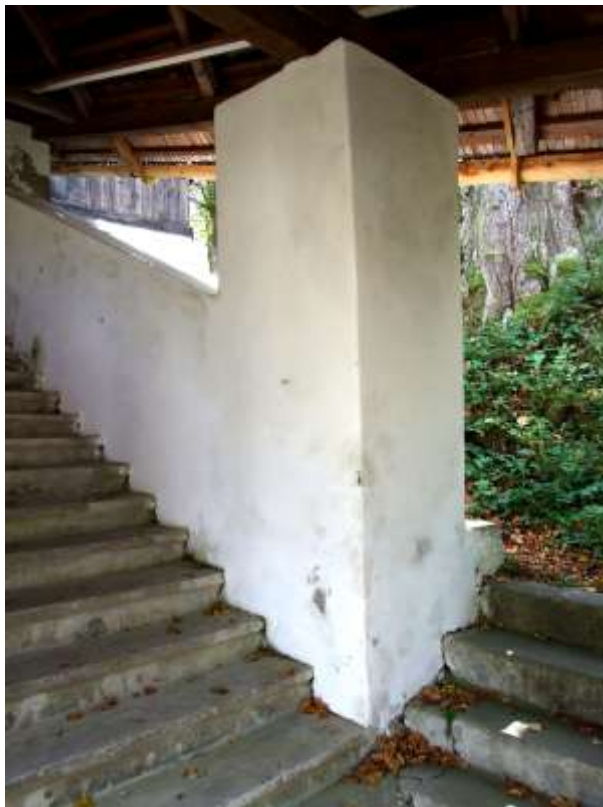
Obr. 6.2. Schodisko k hlavnému vstupu do kostola, vlhkostné fláky sú až po vrchný okraj murovaného stĺpu
