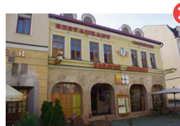
▲ 47. Reklama umiestnená nad kordónovou rímsou nie je vyhovujúca.
