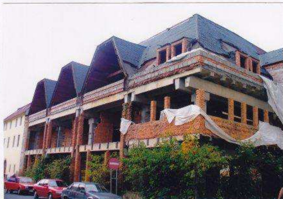
Nevhodná zástavba parciel domov na Námestí Majstra Pavla 23-25 vo vyústení do Mäsiarskej ulice. Novostavba je neproporčná objemovo, má nevhodné prestrešenie a chátra od 90-tych rokov 20.stor.
