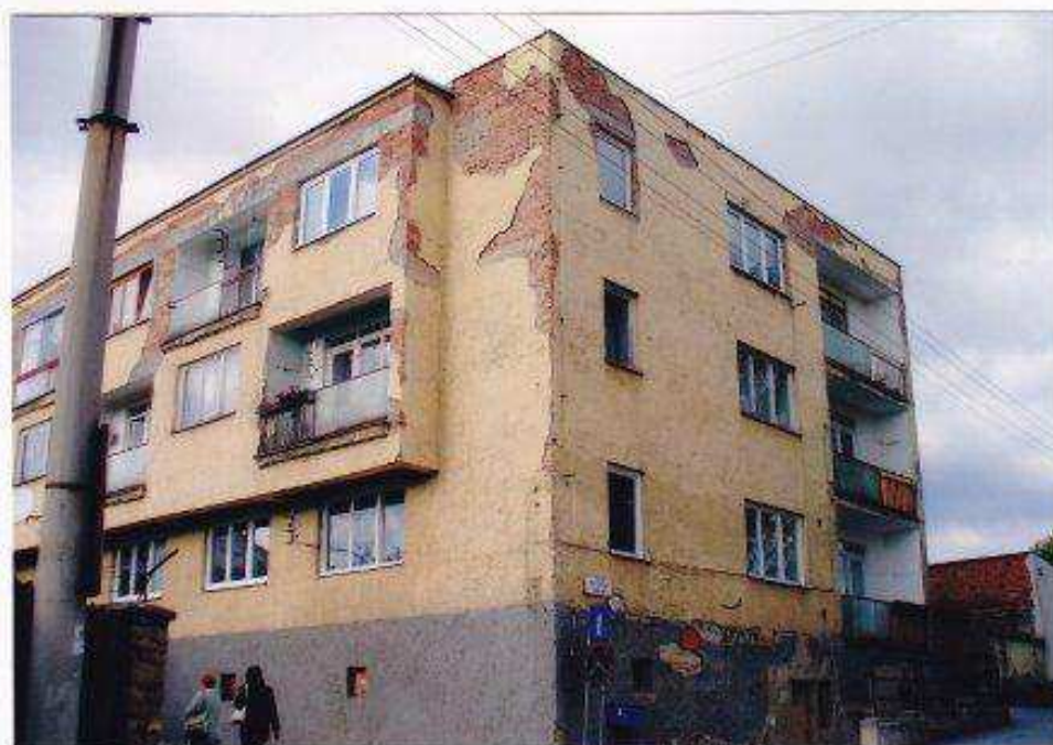
Nevhodná zástavba Kukučínovej ulice v kontakte so vstupom do pamiatkovej rezervácie z Probstnerovej cesty (pri bašte Tlačiareň).
