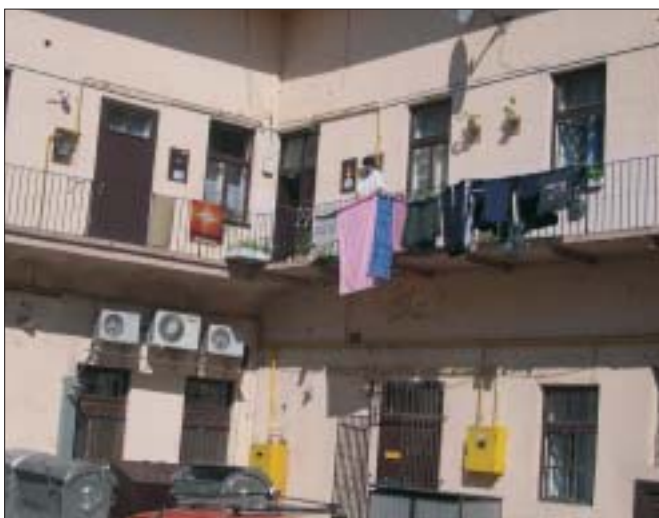
Nevhodné rozvody a klimatizačné zariadenia
