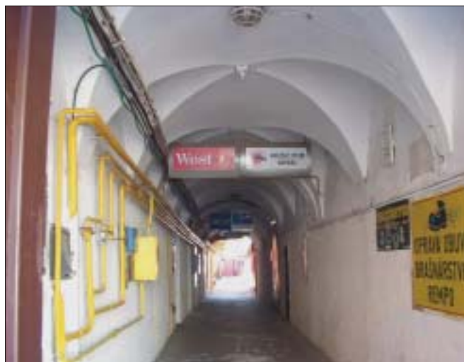
Nedôstojné trasovanie rozvodov v prejazde
