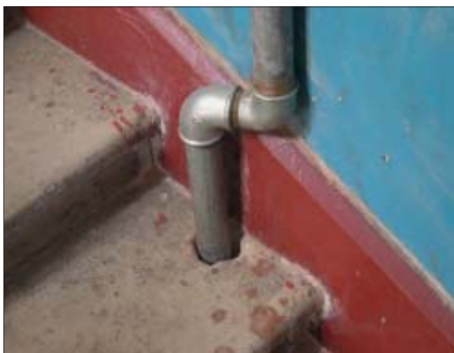
Rozvody, prerazené schodiskom
