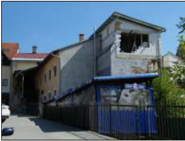
99. Dolná 22, meštiansky dom. Nevhodná nadstavba dvorového krídla, predsunutie horného podlažia pred líce fasády, kvôli kompenzácii hmoty zastrešenie len plytkou pultovou strechou.
