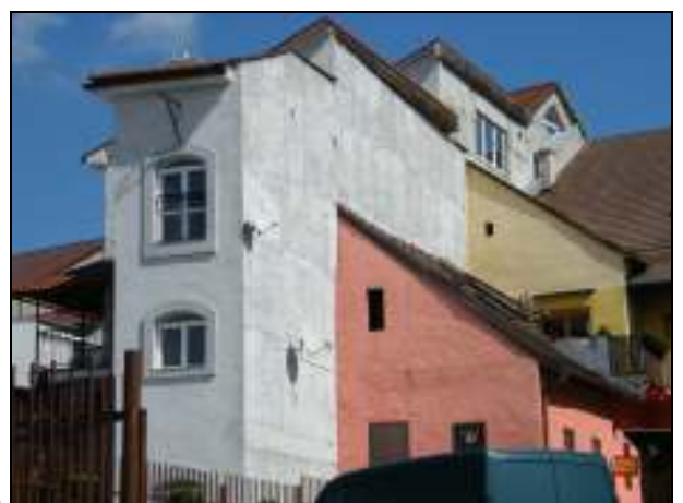
103. Dolná 26, meštiansky dom. Dostavba dvorového krídla, Nevhodné perforácie štítových murív oknami, vrátane štítu uličného krídla.
