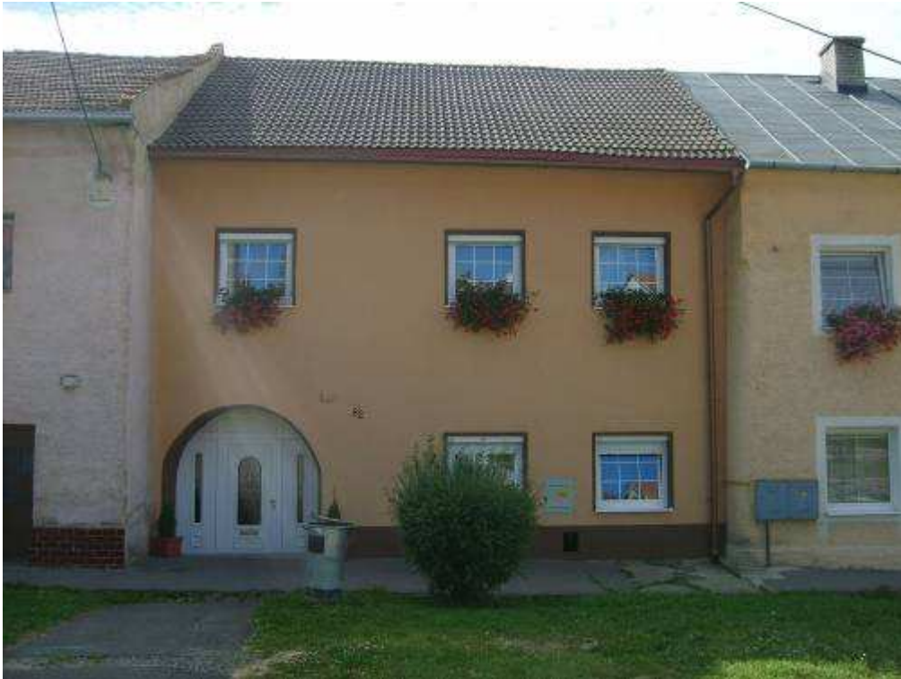
121. objekt súp. č. 82 – objekt s pamiatkovými hodnotami (žiaduce je prinavrátenie historického stvárnenia fasády)
