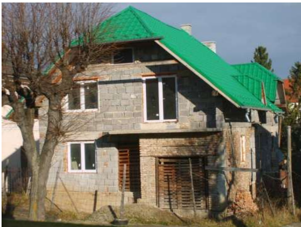
270. Petzvalova ulica č. 31, parc. č. 1073, 11/2010 - objekt rešpektujúci pamiatkové hodnoty územia svojím situovaním, hmotovo – priestorovým usporiadaním, vyžadujúci zmenu strešnej krytiny
