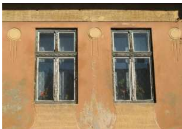
467. Petzvalova ulica č. 3, drevené výplne okenných otvorov hlavnej/južnej fasády, 11/2012
