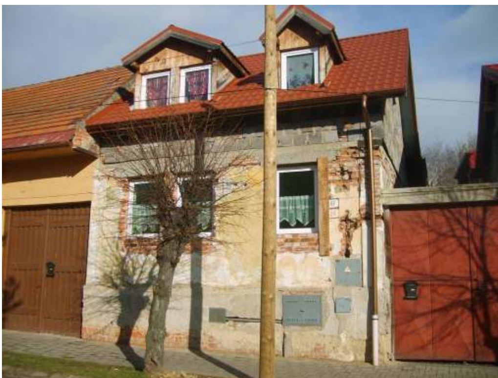
318. Štefánikova ulica č. 24, parc. č. 512/1, 11/2010 – objekt rešpektujúci pamiatkové hodnoty územia svojim situovaním, pôdorysným usporiadaním, vyžadujúcim úpravu architektonického vzhľadu
