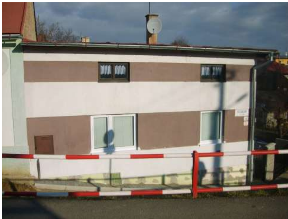
294. Petzvalova ulica č.65, parc. č. 1121, 11/2010 – objekt rešpektujúci pamiatkové hodnoty územia svojím situovaním, hmotovo – priestorovým usporiadaním a architektonickým stvárnením, vyžadujúcim úpravu tvaru zastrešenia
