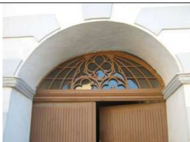
429. Zimná ulica č. 8, drevená výplň nadsvetlíka vstupnej brány do prejazdu, 11/2012
