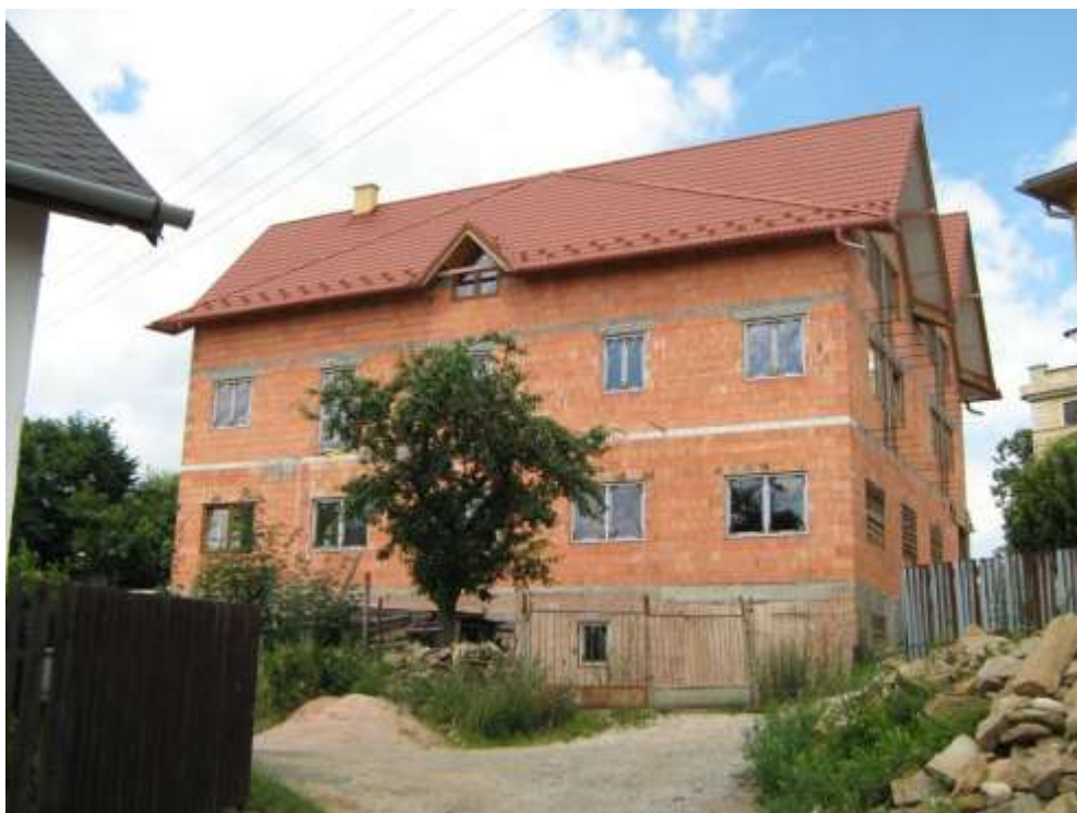
384. Letná ulica č. 12, parc. č. 1044, 09/2010 – objekt nerešpektujúci pamiatkové hodnoty územia, svojím hmotovo – priestorovým usporiadaním
