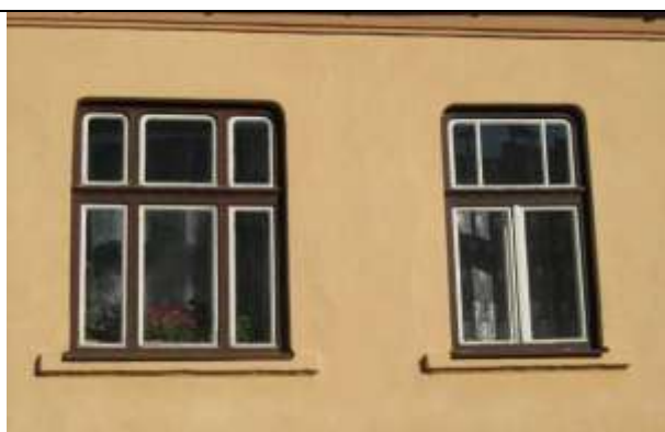
468. Petzvalova ulica č. 5, drevené výplne okenných otvorov hlavnej/južnej fasády, 11/2012
