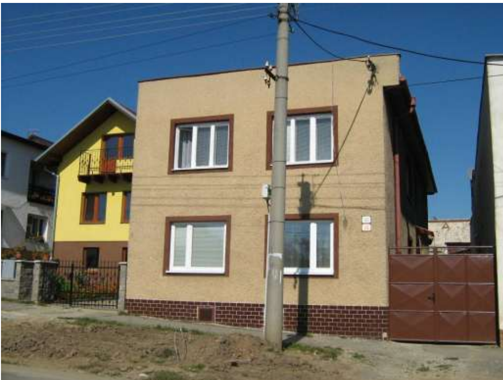
370. Slnčná ulica č. 39, parc. č. 749, 09/2010 – objekt rešpektujúci pamiatkové hodnoty územia svojim situovaním a pôdorysným založením, vyžadujúci úpravu architektonického vzhľadu (fasáda, zastrešenie, okná, brána)
