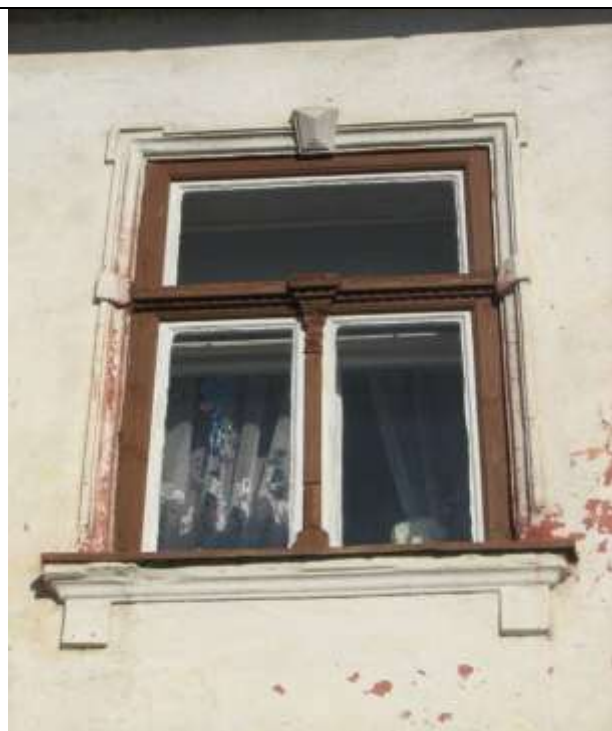
483. Slnecná ulica č. 17, drevená výplň okenného otvoru hlavnej/južnej fasády, 11/2012
