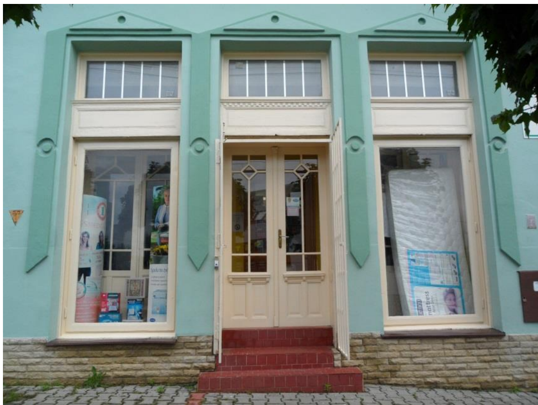
Hlavné námestie č. 16, parc. č. 1595, pôvodné secesné výkladce okenného typu.
