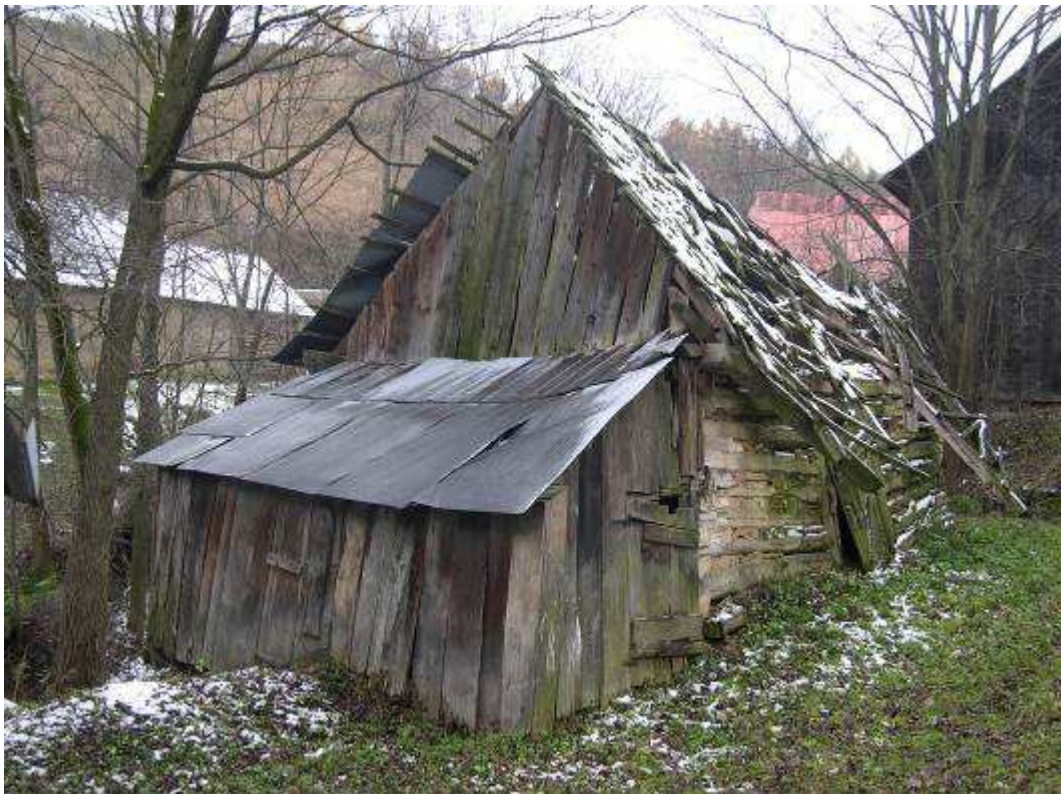
Obr. 98 – usadlosť č. 29 – zrubová hospodárska stavba – súčasný zlý stav
