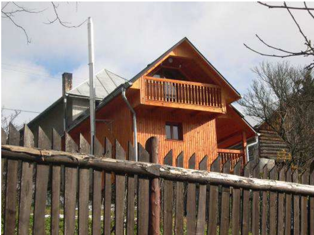
Obr. 18 – usadlosť č. 7 – obytný dom – neadekvátna novodobá úprava sypanca
