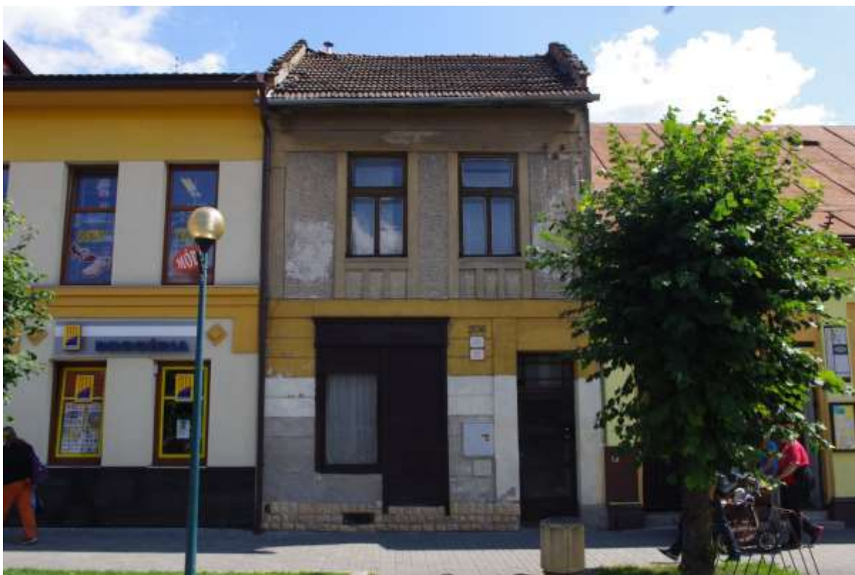
Belanského ulica, súpisné číslo 205, parcelné číslo KN 83, predmetom ochrany je: H – hmota uličného krídla, F – fasáda so štukovou výzdobou, P – riešenie parteru obchodných prevádzok, U – štuková výzdoba fasády, S – tvar a forma zastrešenia
