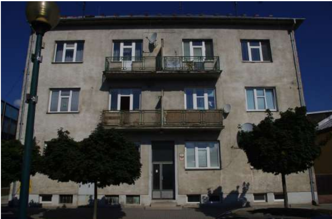
Belanského ulica, súpisné číslo 557, parcelné číslo KN 288 - osadením objektu bola narušená: historická parcelácia, objektová skladba, tradičné materiálové riešenie, výškové a hmotové usporiadanie ulice, panoráma a silueta územia, návrh – humanizácia a rekonštrukcia objektu, nepresiahnuť výškovú úroveň súčasnej strechy
