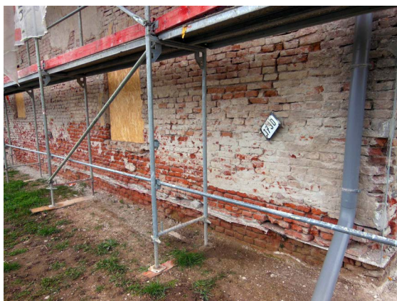
► Obr. 41. Objekt depozitára Pamiatkového úradu SR v Trnave, ktorý bol sanovaný kombináciou viacerých spôsobov.
