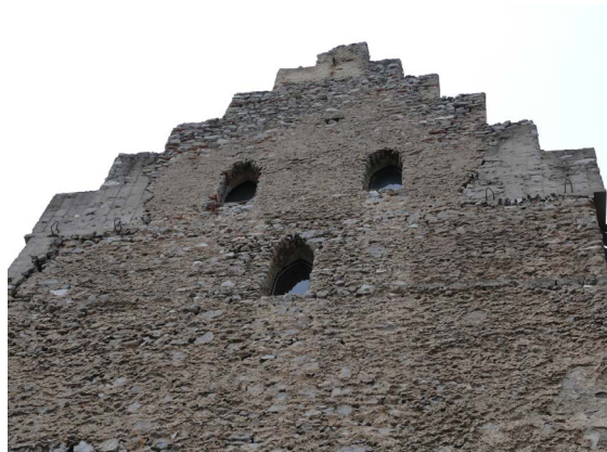
►► Obr. 21. Poškodenie všetkých konštrukcií stavby zanedbanou údržbou strešnej roviny. Meštiansky dom, Banská Štiavnica, 2008.
