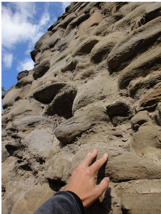
► Obr. 5. Poškodenie muriva z pieskovca, pre ktoré je najlepšou konzerváciou aplikácia mäkkej priedušnej omietky.
