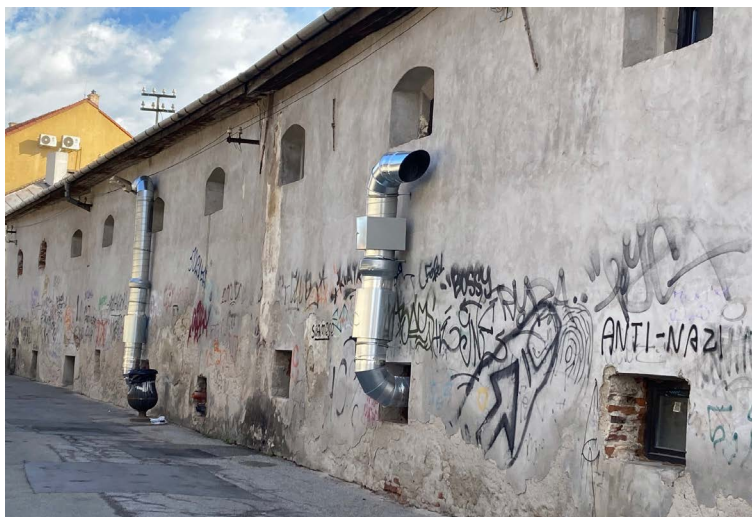
► Obr. 30. Vzduchotechnika na uličnej fasáde.
